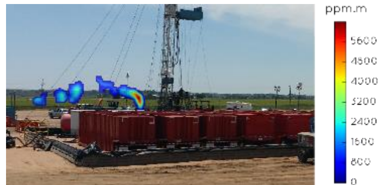
石油採掘場の処理タンクからのガス漏れ
