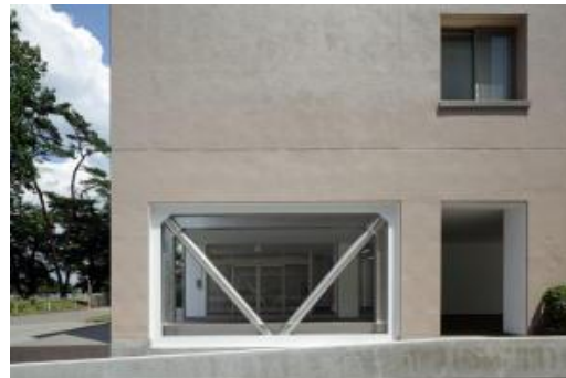
図3 ステンレスブレースによる耐震補強 (宇都宮大学陽東キャンパス8号館)
