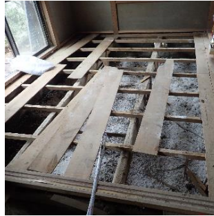
居住者向け浸水被害軽減マニュアルの開発 (写真は被害調査例)
